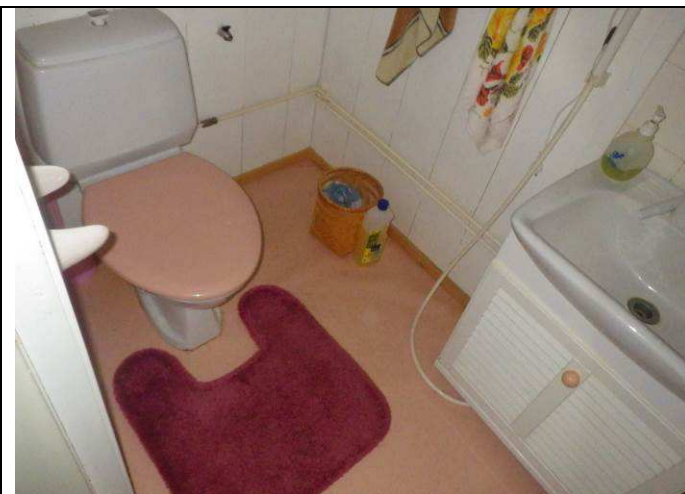
25. Yläkerran wc:ssä on ollut saadun tiedon mukaan vesivuoto
