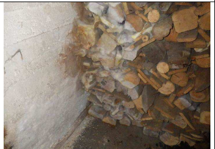
6. Homekasvustoa polttoainevaraston seinässä
