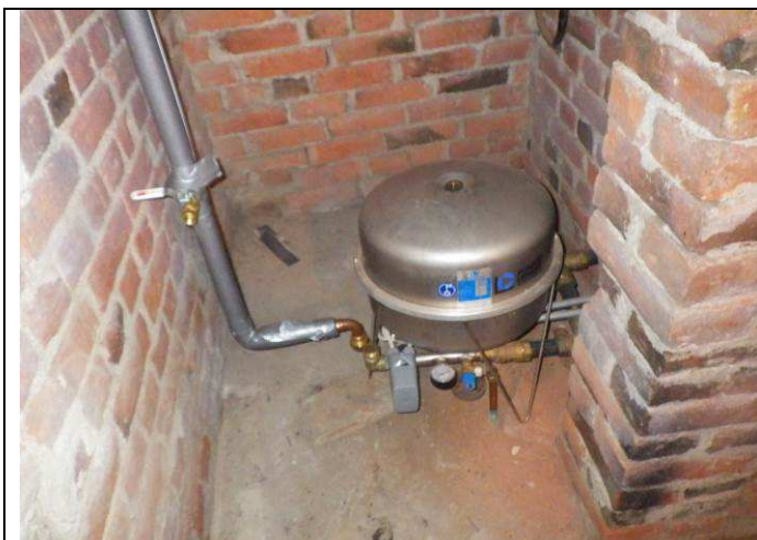
36. Käyttövesijärjestelmän putkistoa ja laitteistoa
