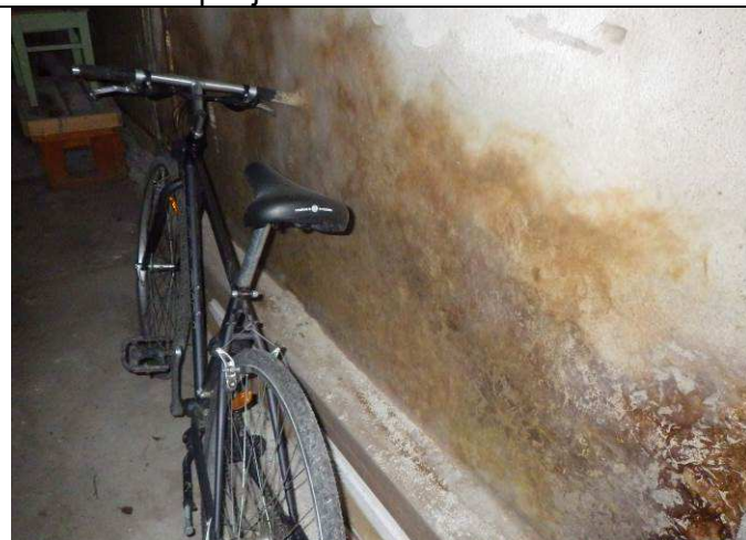
5. Homekasvustoa kellarin autotallin seinässä
