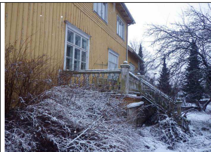
11. Takaterassi on lahovaurioitunut
