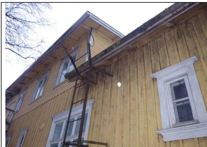
15. Räystäsrakennetta, talotikkaan kiinnitys näyttää huteralta
