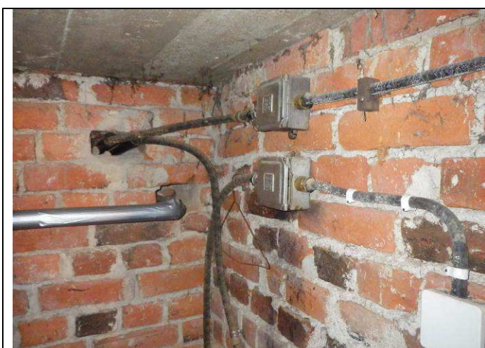
38. Kellarin ikääntyneitä sähköjä
