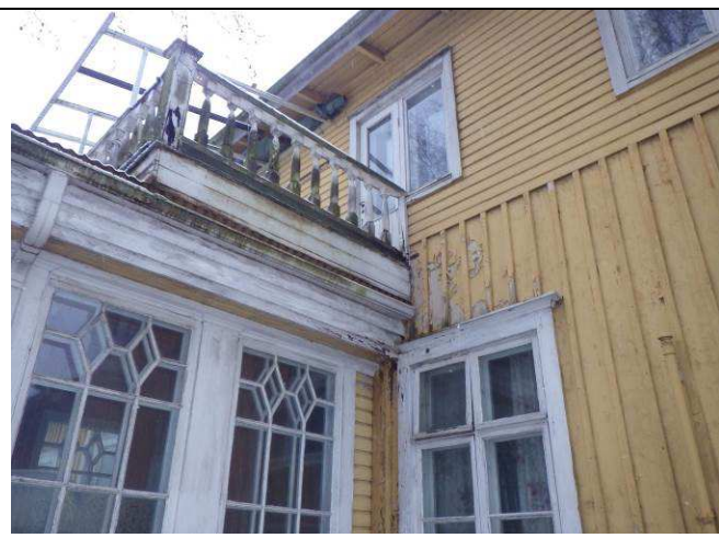
16. Kosteusjälkiä vuotaneen parvekkeen alapuolisissa rakenteissa
