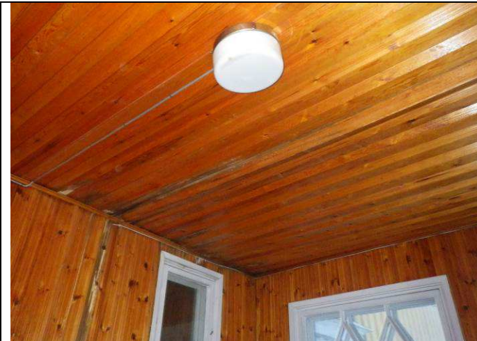
29. Kosteusvaurioita parvekkeen alapuolisella kuistilla
