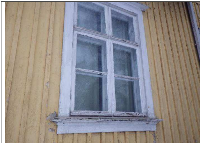
13. Ikkunoissa kunnostus / uusimistarve
