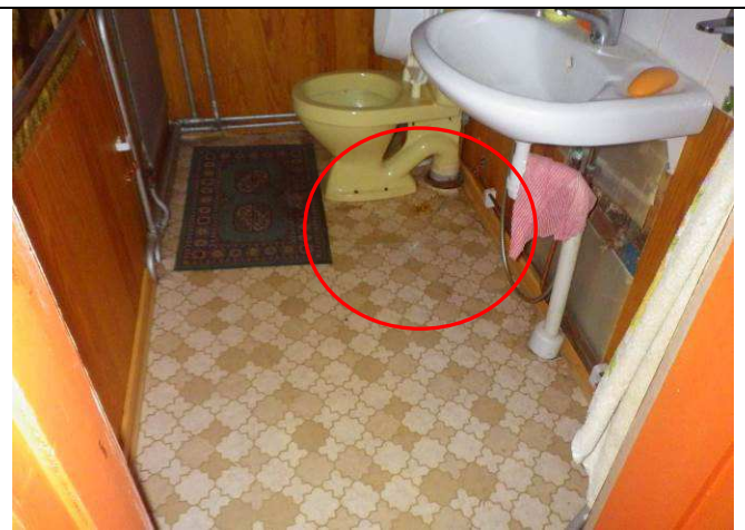
26. Alakerran wc:tä, lattiassa on kosteuden aiheuttamia jälkiä
