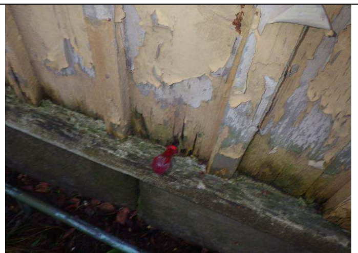
12. Ulkoseinien alaosissa havaittiin kosteus- ja lahovaurioita
