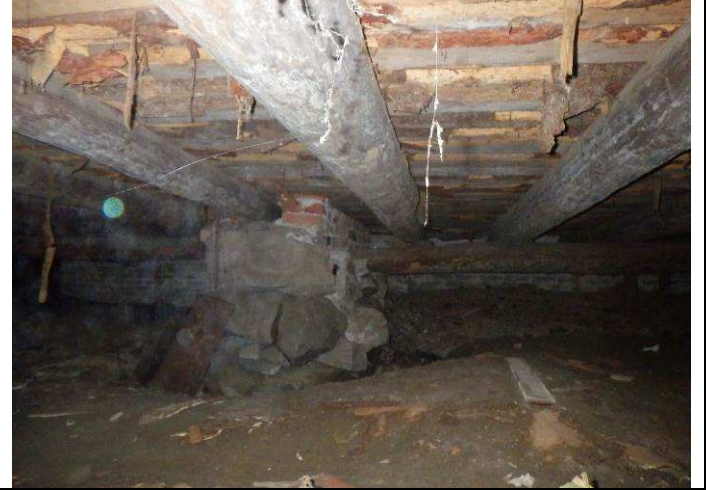
2. Rossipohjaa, aluslaudoissa näkyy kuoriaisten tekemiä jälkiä
